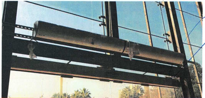
Cortinas de aire Nave Lewis
